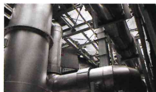
プラント配管
